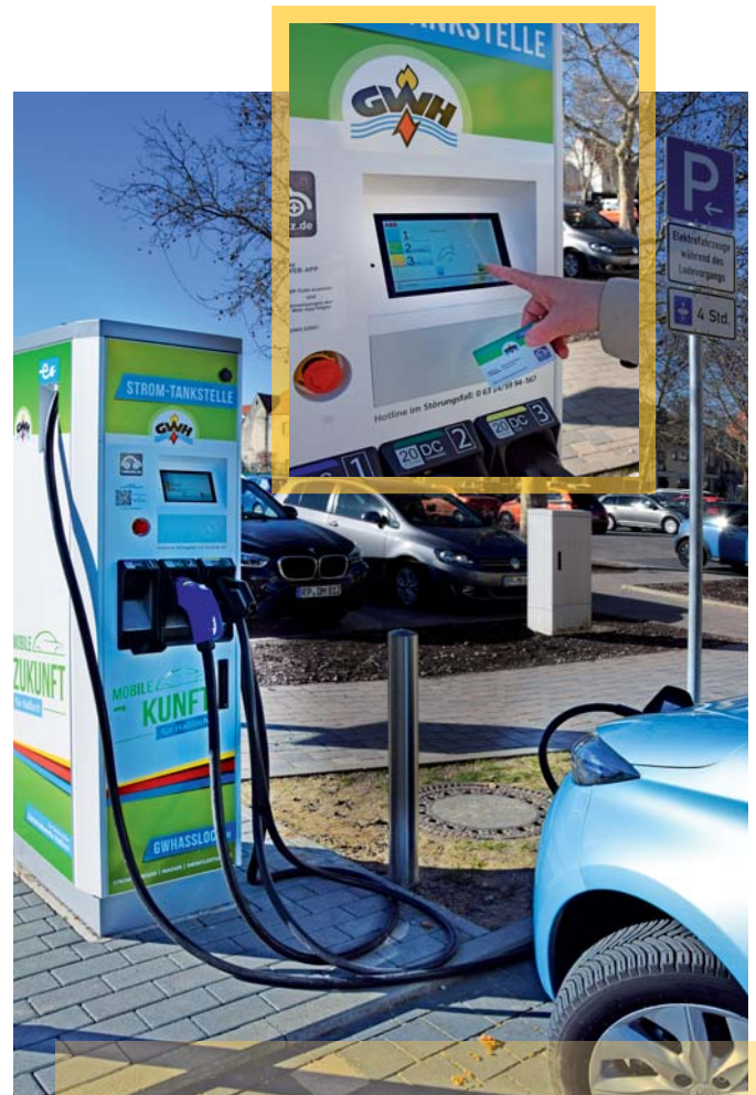
Schnell-Ladesäule der GWH in der Schillerstraße, Haßloch
